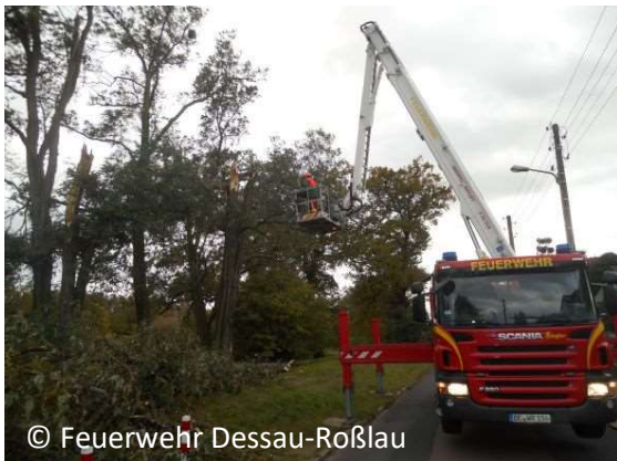
Eine abgebrochene Baumkrone wird beseitigt.
