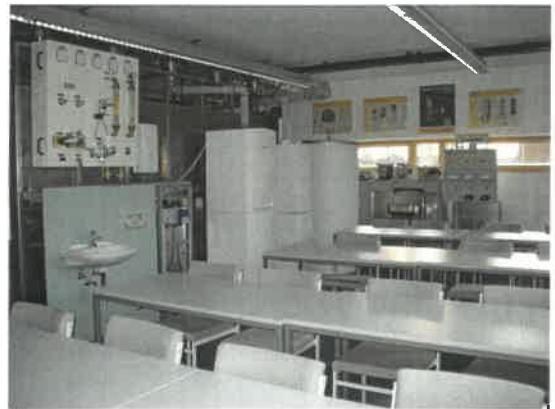
Sanitär-, Heizungs- und Klimatechnik
