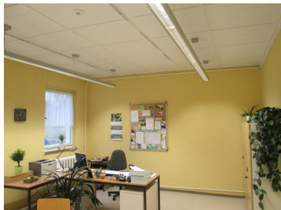
LED-Leuchten im Bürobereich
